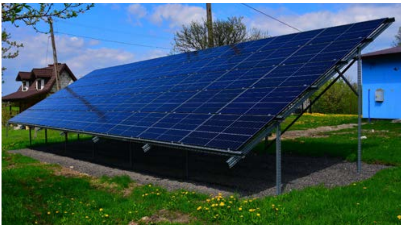
Instalacja fotowoltaiczna zna ujęciu wody
